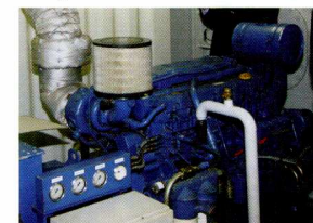
Einer der beiden Volvo-Penta Generatormotoren mit 160 kVA
